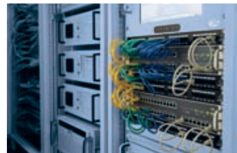
INTUS ACM8e Rack mit Patch-Panel
