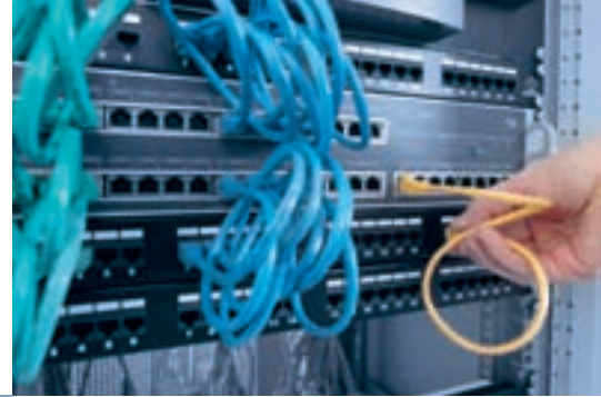
INTUS ACM8e Rack mit Patch-Panel
