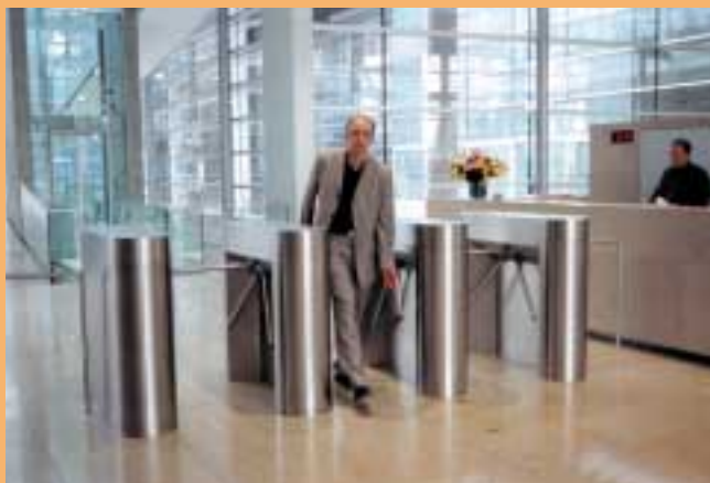
Zutrittskontrolle im Haupteingang des neuen Swiss-Re-Verwaltungsgebäudes
