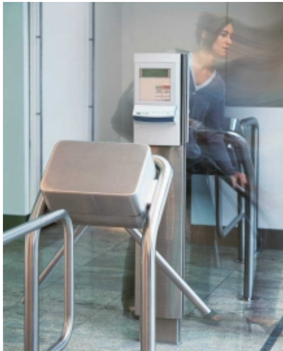
Bild 1 (links): An Eingängen mit Vereinzelungseinrichtungen kann eine Kopplung von ZK und PZE erfolgen [Aufnahme bei Bosch Siemens Hausgeräte GmbH]
