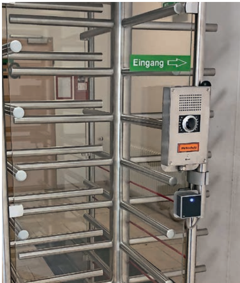
Ein Drehkreuz mit Zutrittsleser schützt den Personaleingang.
